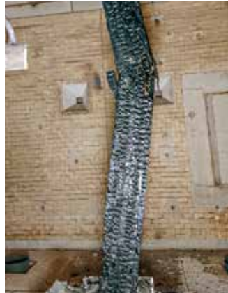
Figur 6. Pelare av limträ där kollaps skedde under avsvälningen 2 .
