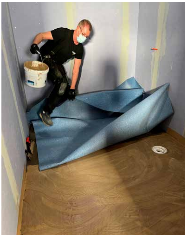
Två av de större leverantörerna av plastmattor och linoleum har under hösten och vintern 2021/22 deltagit i flera projekt där man utgått från en befintlig limprodukt baserad på lågalkalisk cement för att limma mattor mot underlaget. En golvläggare behöver ett lim med initialhäfta för mattan som kan vara styv och svår att forma.
