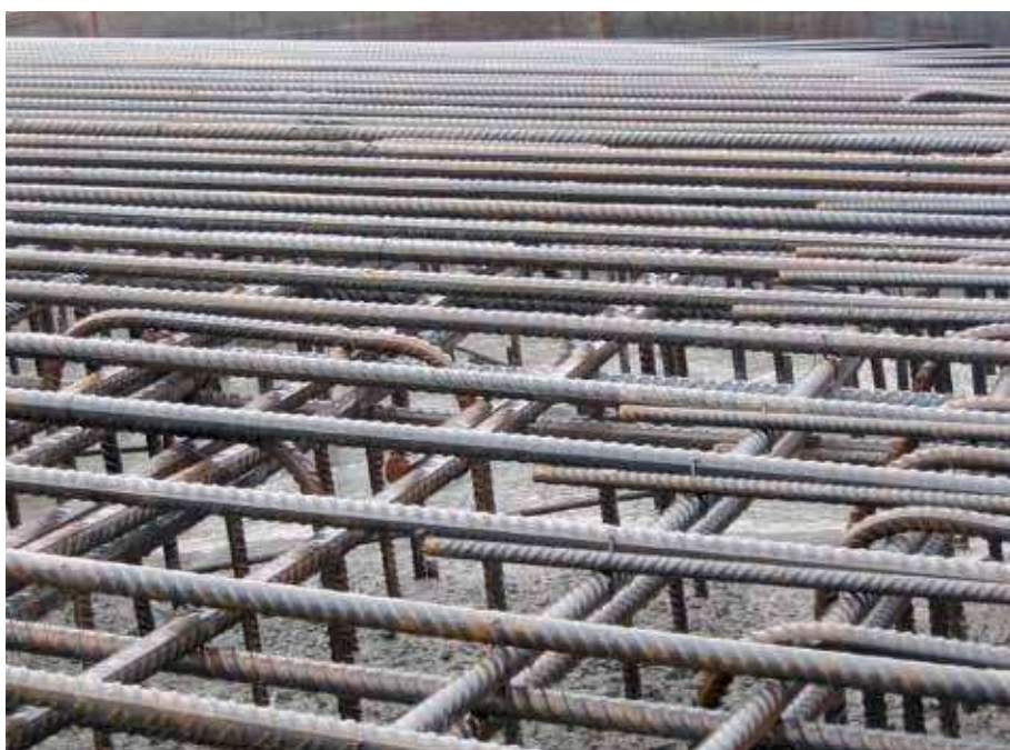
När järnet i armeringen börjar rosta utvidgas det och kan ge sprickor i betongen. Foto: Enercon
